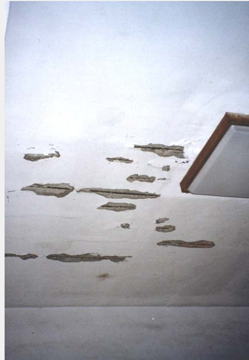
保護層薄弱處 混凝土掉落及鋼筋外露
