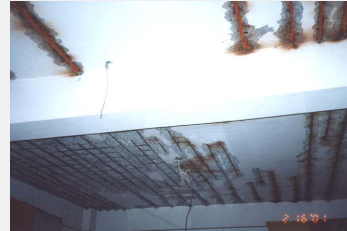
樓版鋼筋外露及腐蝕
