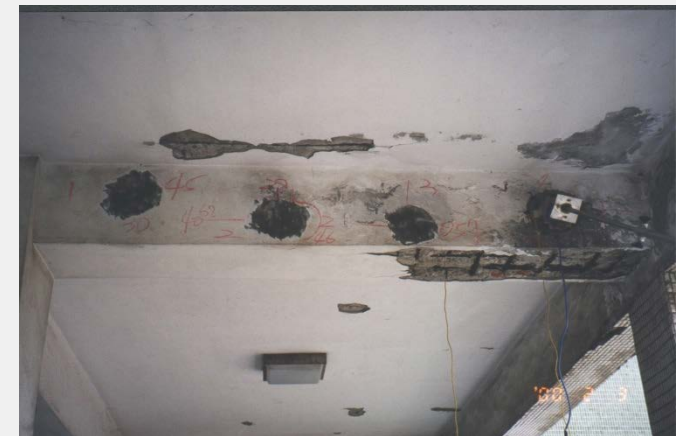
嚴重時導致主結構鋼筋外露
