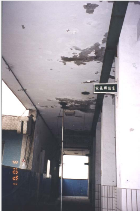
使用海砂材料的建物
