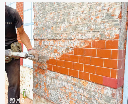
正面外牆後期以丁掛磚貼作，磁磚剝除後砂漿也難以清除，紅磚面斑駁。
