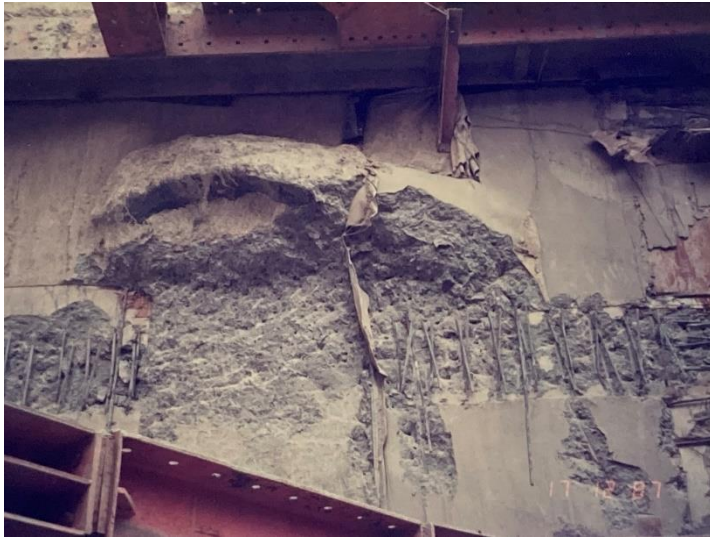
擋土支撐與連續壁混凝土爆漿處
