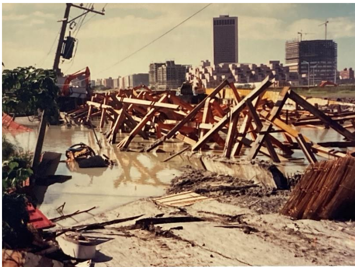
地下室開挖失敗案例 1988年信義計畫區
