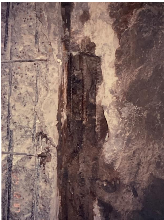
地下室 開挖 連 續壁接 合處包 泥 漏漿
