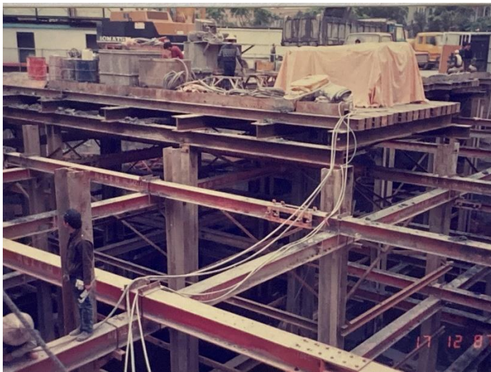
地下室開挖 連續壁接合處 漏漿應變處置
