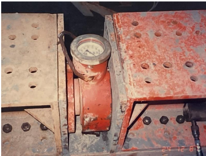
地下室開挖 安全支撐上之土壓計
