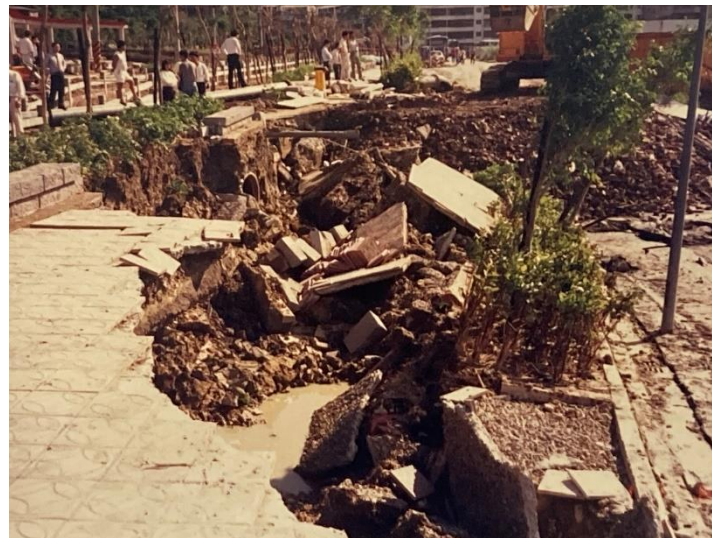
地下室開挖失敗案例 1988年信義計畫區
