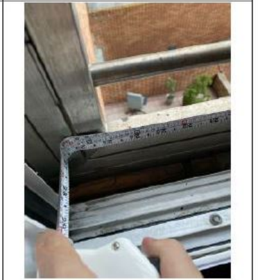
編號 6 陽台違建: 已留設開口寬度 76cm
