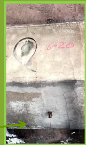
預測300 °C處 混凝土顏色變化
