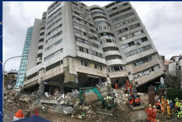
雲門翠堤大樓嚴重傾斜
