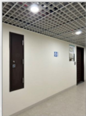
加大單元管道間
