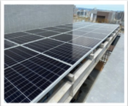
太陽能光電板 產生能源每年2萬3980KW
