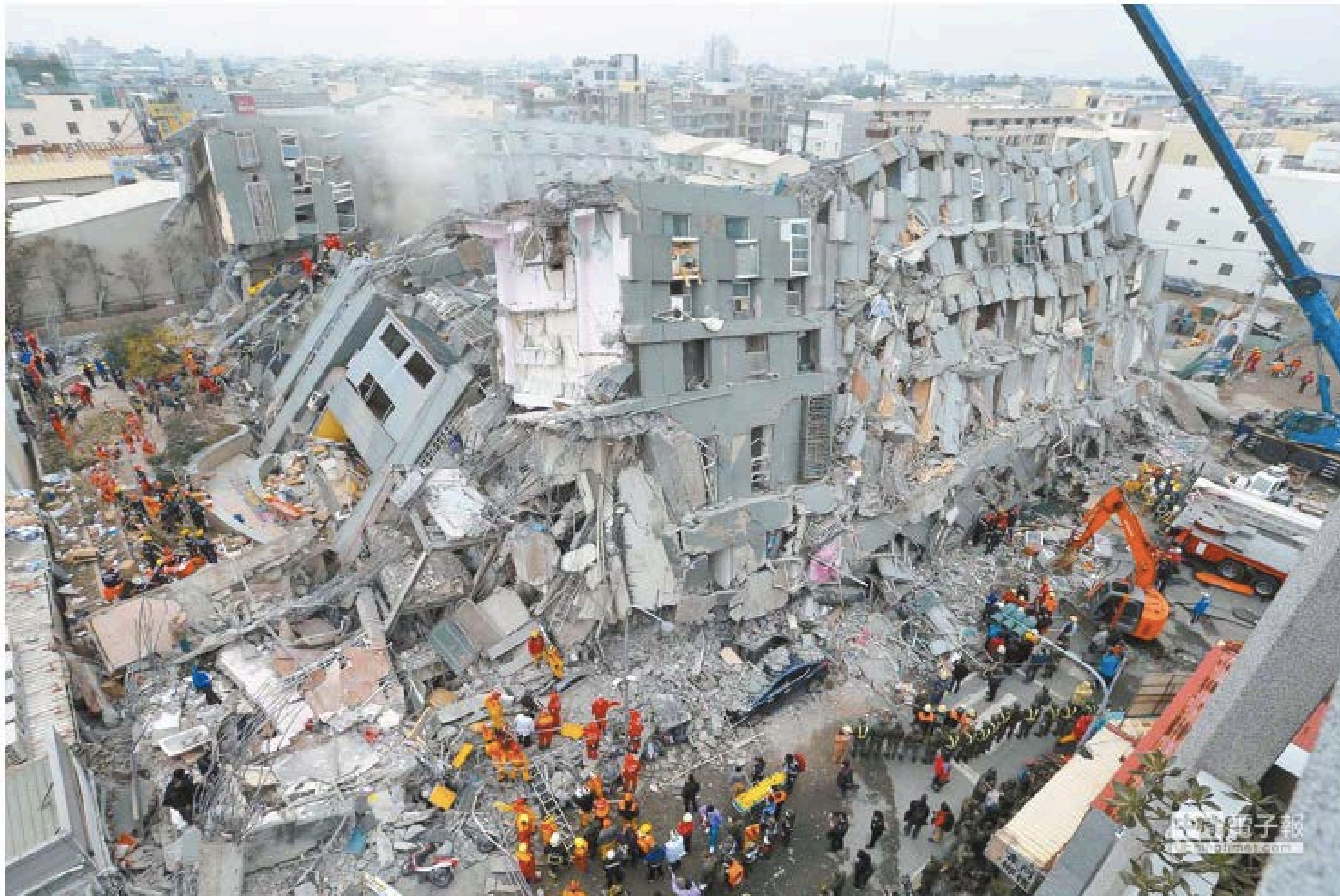
台南維冠金龍大樓在強震後攔腰折斷，起造的建商、建築師等人均被判刑5年確定。(本報資料照片)
