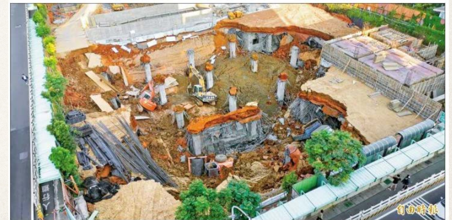
去年平鎮停車場工程崩塌釀1死。(資料照)
