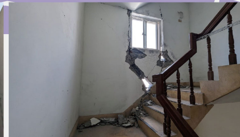
圖6 403地震花蓮民宅大樓破壞內部照片
