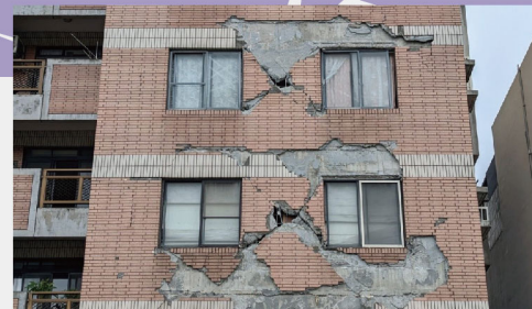
圖5 403地震花蓮民宅大樓破壞外部照片
