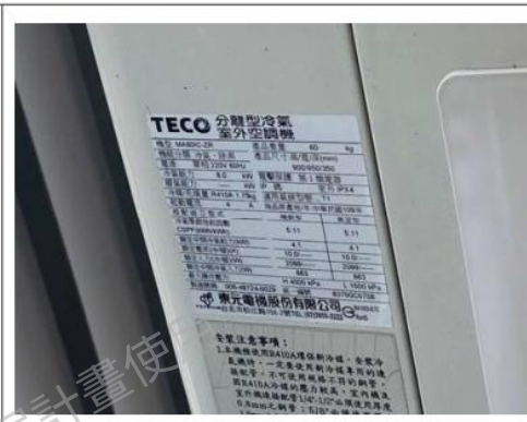
視聽教室個別空調室外機銘牌
