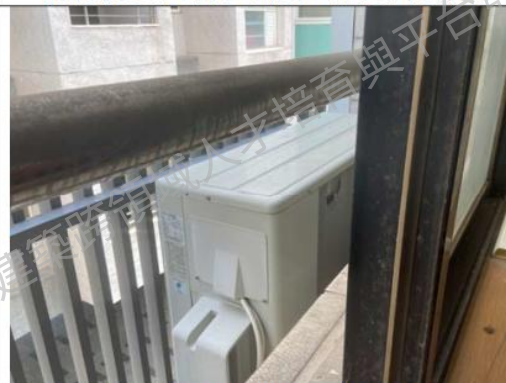
視聽教室個別空調室外機安裝情況
