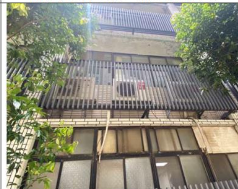
健康中心個別空調室外機安裝情況
