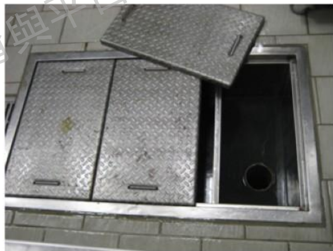
油脂分離設備，以降低排放污水中的有機物含量
