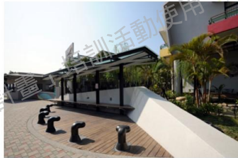
以鋼構屋頂結合太陽能板之等候亭
