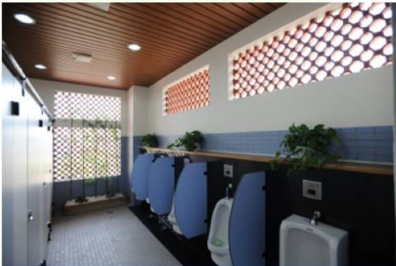
廁所內省水自動沖水器小便斗
