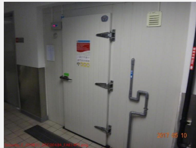
垃圾前置處理設施(冷藏櫃)
