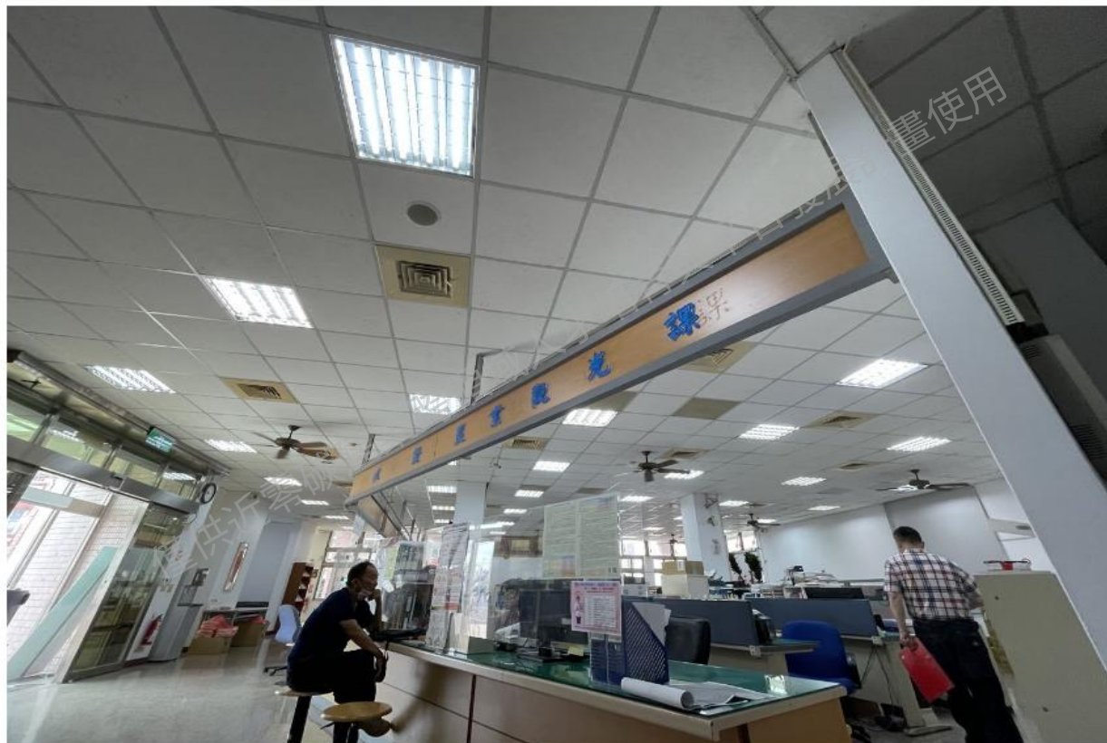
主要作業空間照明現況照片
