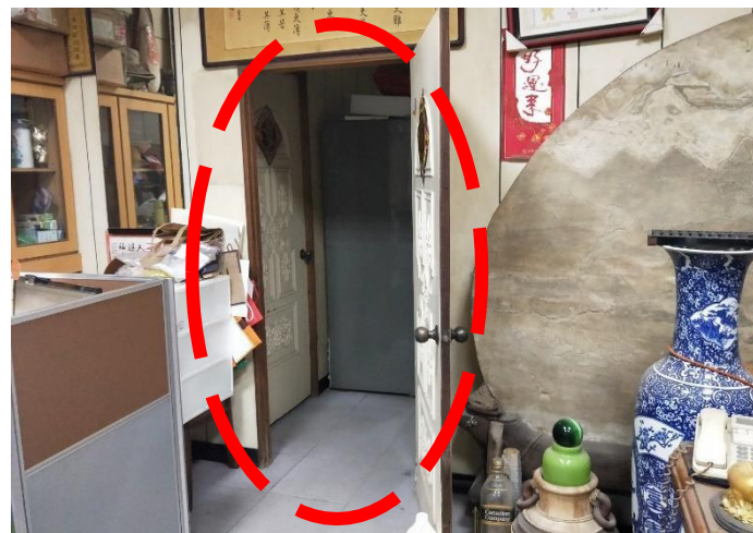
屬防火區劃之大門出入口未設置防火門
