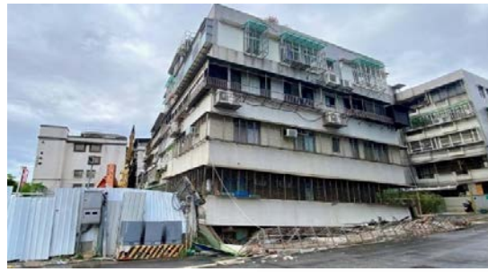
大直建案施工鄰房坍塌現場
