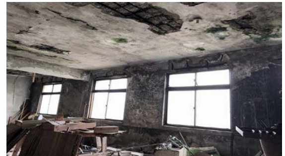
海砂屋鋼筋曝露現場
