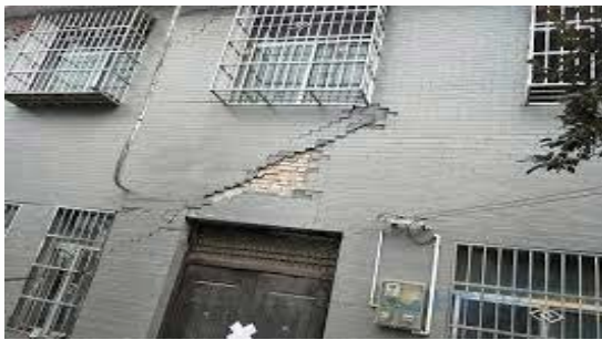
地震牆面損害現場
