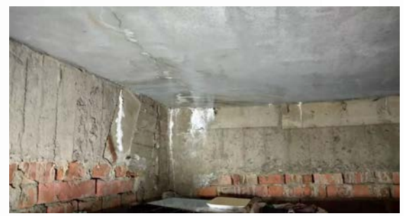
天花板裂縫滲水現象
