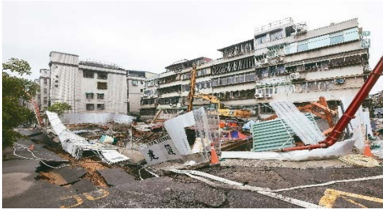
大直建案施工坍塌現場
