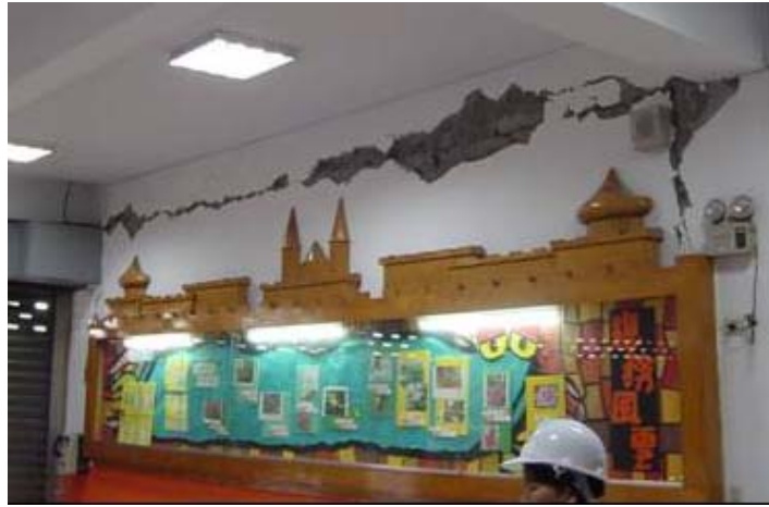
安和國小補強之剪力牆於311地震中破壞照片
