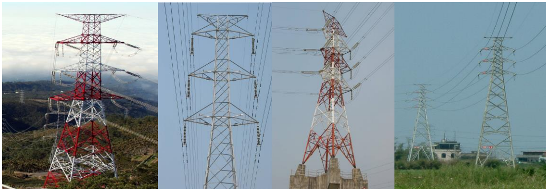
圖 2.4 鐵塔型支持物外觀(用於 345 仟伏、161 仟伏、69 仟伏)
